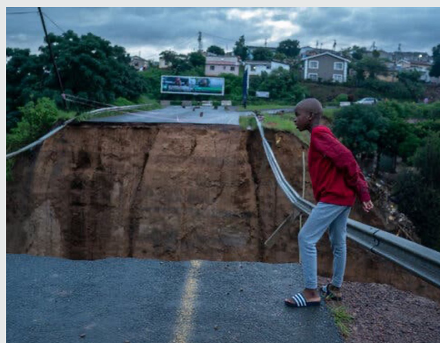
Source : Joao Silva/The New York Times. Les phénomènes météorologiques extrêmes deviennent plus fréquents et plus graves en raison du changement climatique, avec des conséquences dévastatrices pour les infrastructures de transport, les services et les travailleurs.
